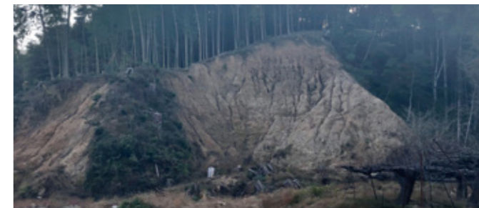
朝倉市崩落現場
