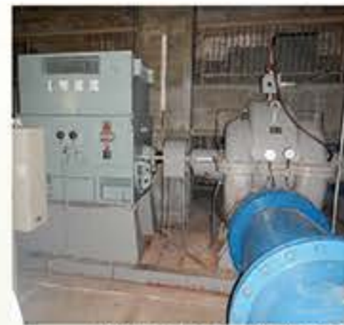
知多浄水場ポンプ設備(更新前)
