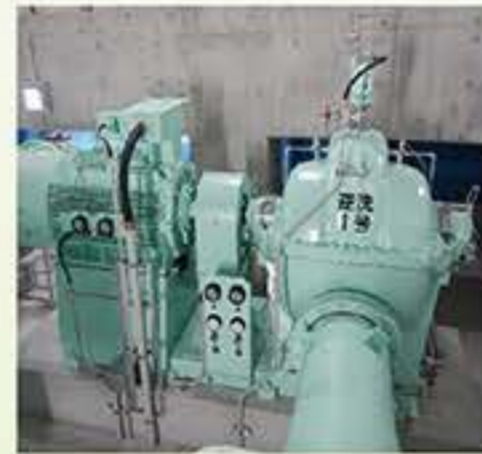
知多浄水場ポンプ設備(更新後)
